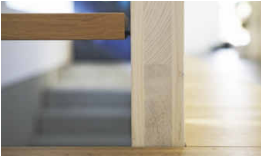
Ein Bauteil – mehrere Funktionen: Schichtholz als Trennscheibe und Treppenwange
